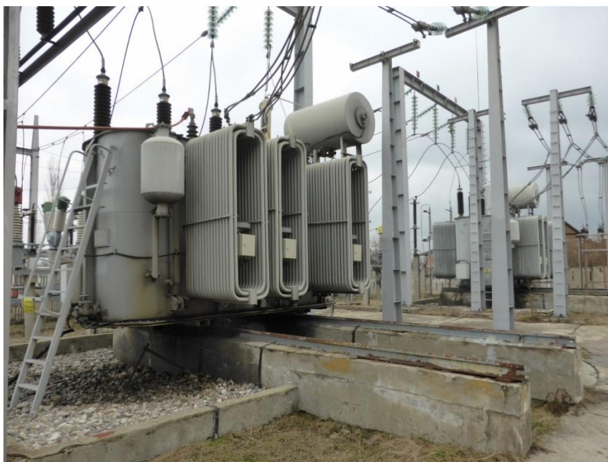
Снимка 9: Трансформатор с подземен контейнер в подстанция „Метро”
