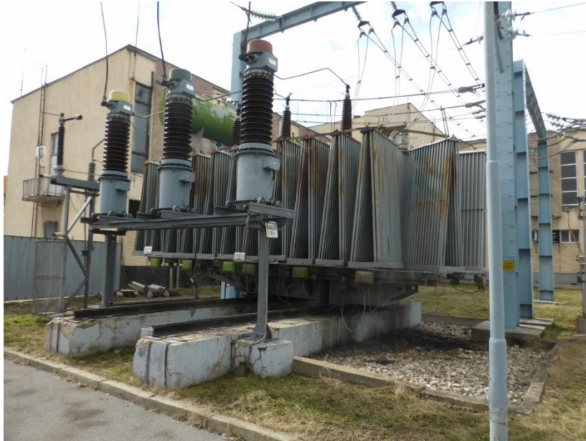
Снимка 5: Един от трансформаторите
