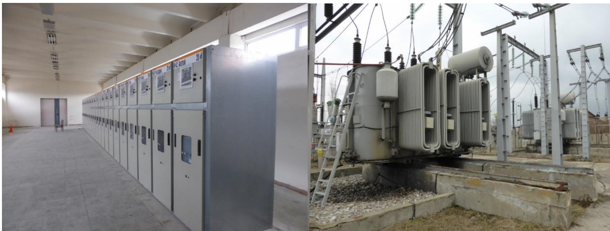
Снимка 3: 20 kV секция и трансформатори на подстанция „Метро“
